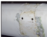
Korozija na jamboru
